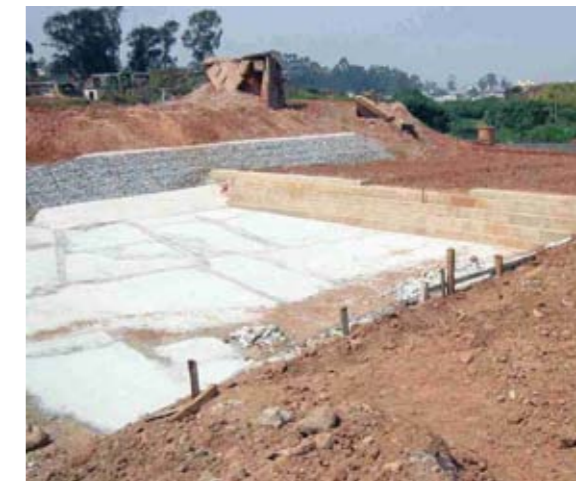
Extravaso construído pela Prefeitura Municipal de São Paulo para direcionar as águas provenientes das cheias do córrego Itaquera para o piscinão construído na Pedreira Lageado.
