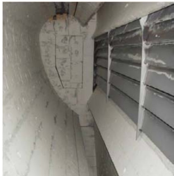
O revestimento interno em placas cerâmicas e o conjunto de aletas (AR Vane Rack) no Aero Classificador a Ar.
