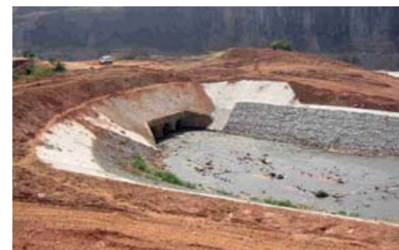
Obras civis do sistema de regularização de vazão do córrego Itaquera que direciona as cheias deste córrego para a antiga cava da Pedreira Lageado, atual “piscinão” do Itaquera.
