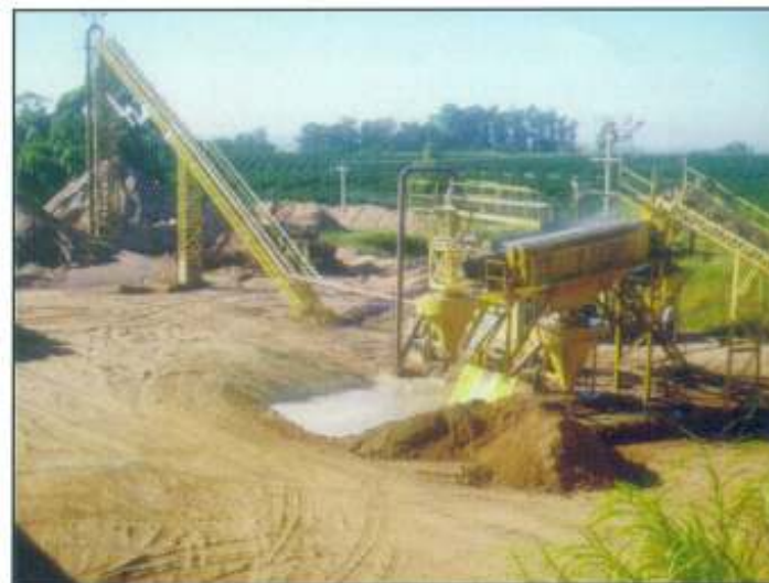
Vista das instalações de beneficiamento da areia
