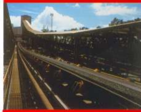
Sistema de manuseio de minério de ferro da instalação MEC - II, da mina do CAUÊ, C.V.R.D. Itabira - M.G.
