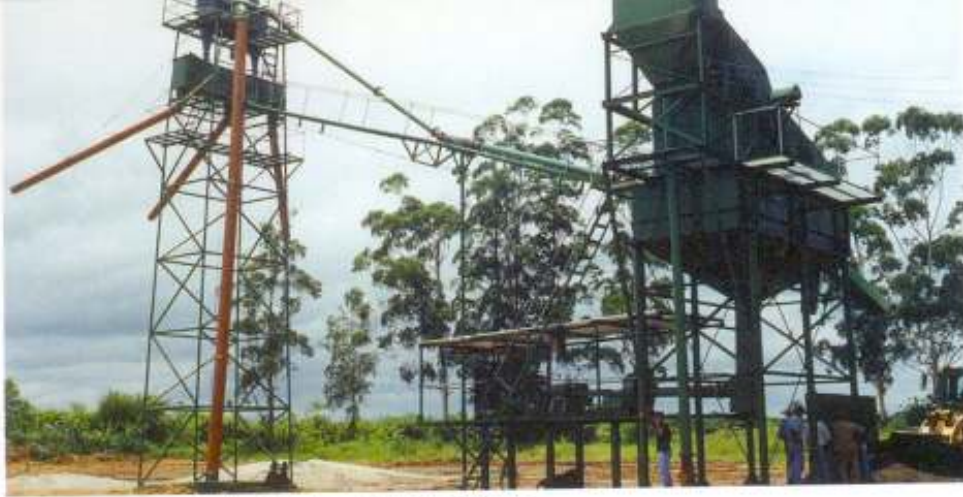
Equipamentos recém-instalados no Vale do Ribeira
