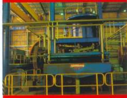
Separador Magnético da Instalação da C.B.M.M.-Araxá-MG
