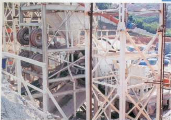
Detalhe da central de concreto
