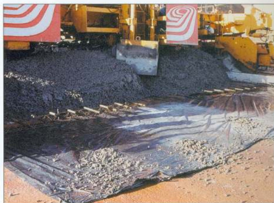
Plástico colocado devido à irregularidades do CCR
