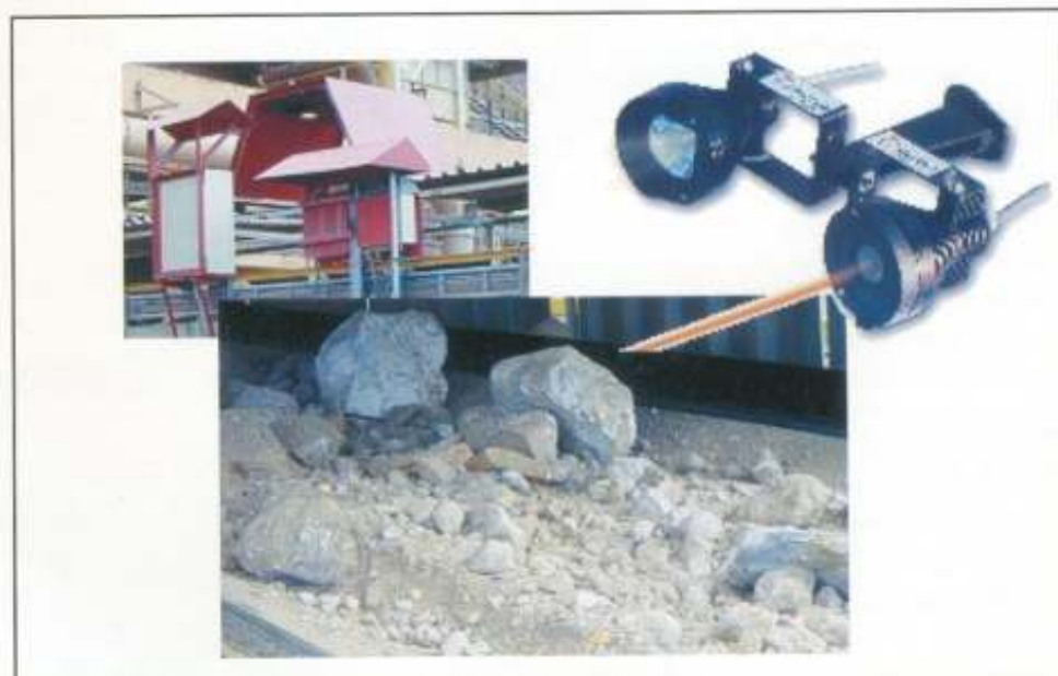
Figura 1 – Instalação VisioRock em uma correia transportadora
