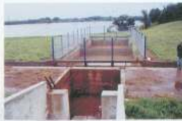
Sistemas de decantação e clarificação de águas. APA - Associação dos Portos de Areia do Noroeste do Paraná
