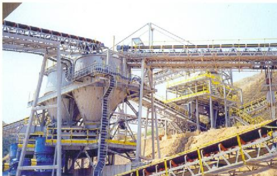
Silos que alimentam os rebitadores
