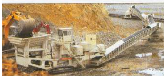
Britagem In-Pit com sistema Lokolink
