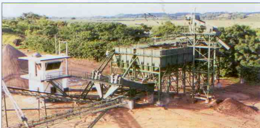
Pulmões com capacidade de 350 metros cúbicos cada, permitindo o armazenamento temporário da polpa descarregada pelos barcos.
