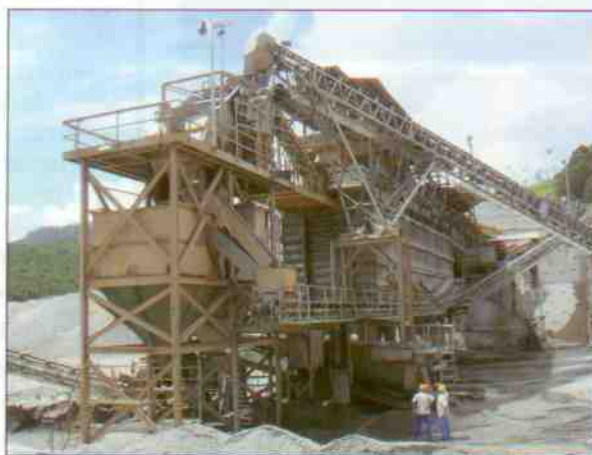
Instalação de produção de areia de brita
