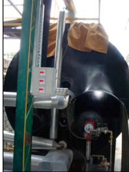
Tanque de asfalto ecológico
