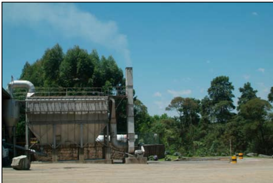
Usina de asfalto – filtro de mangas
