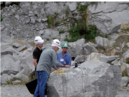
Dispositivo de ruptura instalado
