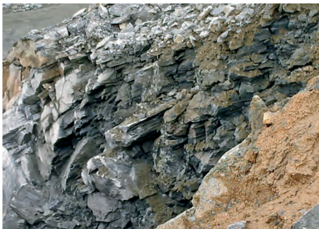
Exemplo de rocha extremamente fraturada
