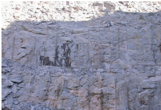
Foto de paredão onde é possível identificar a infiltração de água
