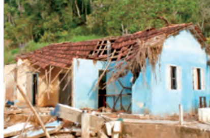
Casa do Sr. Josias Moreira, destruída pela enchente
