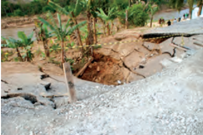
Estrada destruída pela enchente
