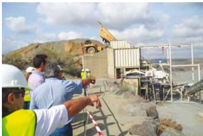
Planta de tratamento de agregados Villaluengo – Grupo CG.
