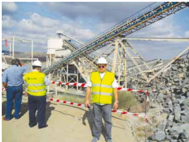
Planta de tratamento de agregados Villaluengo – Grupo CG.
