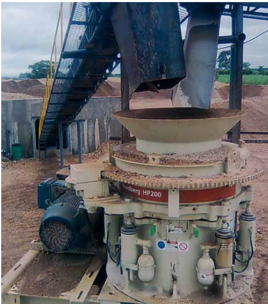
A britagem do seixo pelo HP200 produz areias com diferentes granulometrias que, após o peneiramento, são utilizadas para diversas aplicações especiais
