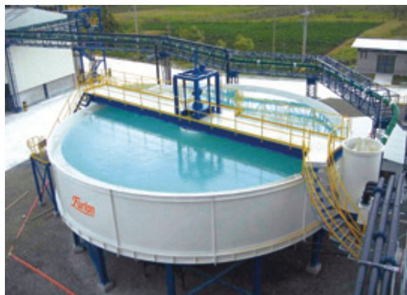
Vista da instalação da unidade de clarificadores/espessadores
