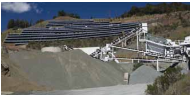
Pedreira Mark West da BoDean Company, California, EUA: Sistema de painéis solares fotovoltaicos composto por 3.000 painéis solares em planta de agregados (brita e areia artificial) com capacidade de 600 t/h. Auto-suficiente em energia elétrica. Pay-back em 5 anos.
