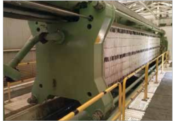
Utilização de filtro – prensa em planta de britagem para desaguamento de filler para descarte em bota-fora e reuso da água.
