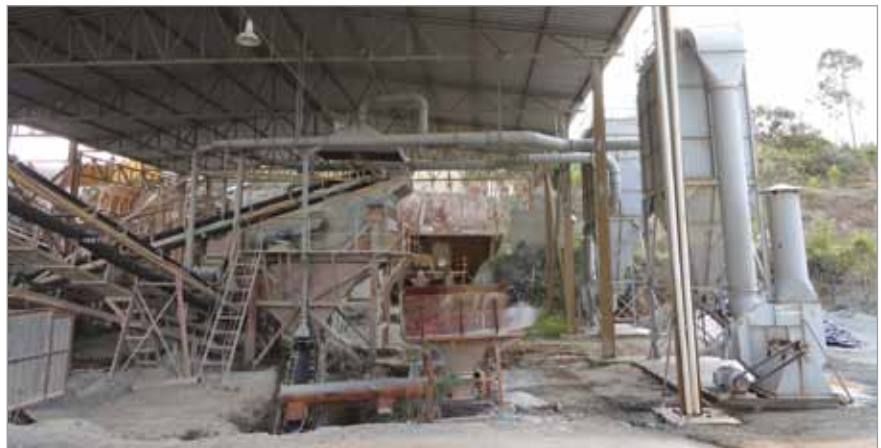
Vista das instalações de britagem.
