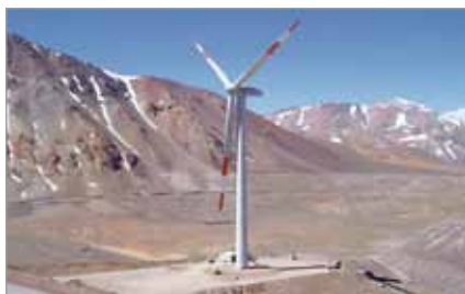
Foto: Turbina eólica (aerogenerador) da mina Veladero, da Barrick Gold Corporation, província de San Juan, Argentina, altitude de 4.440 m.
