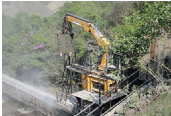
Vista do britador primário.
