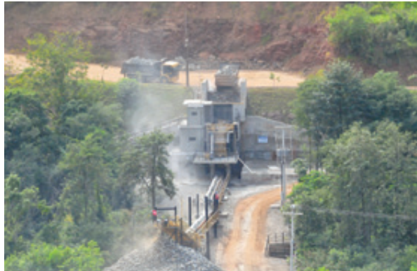
Vista do britador primário.
