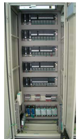
Figura 3: Painel com controladores.
