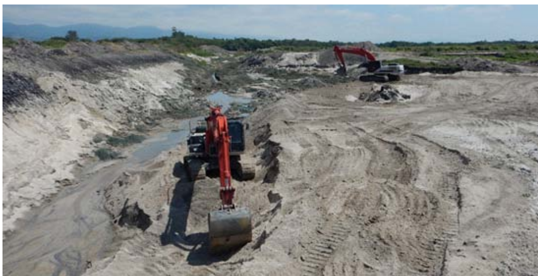
Extração de areia pelo método de escavação mecânica em “cava seca”. Fonte: Mineração de Areia Paraíba do Sul.
